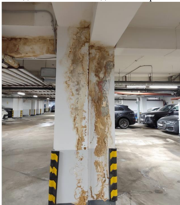
Фото 4 Паркинг. Следы протечки по деформационному шву по границе стены здания в сторону террасы
