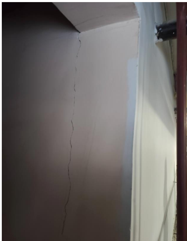
Фото 5 Паркинг. Следы деформаций (трещины) по причине неравномерной
