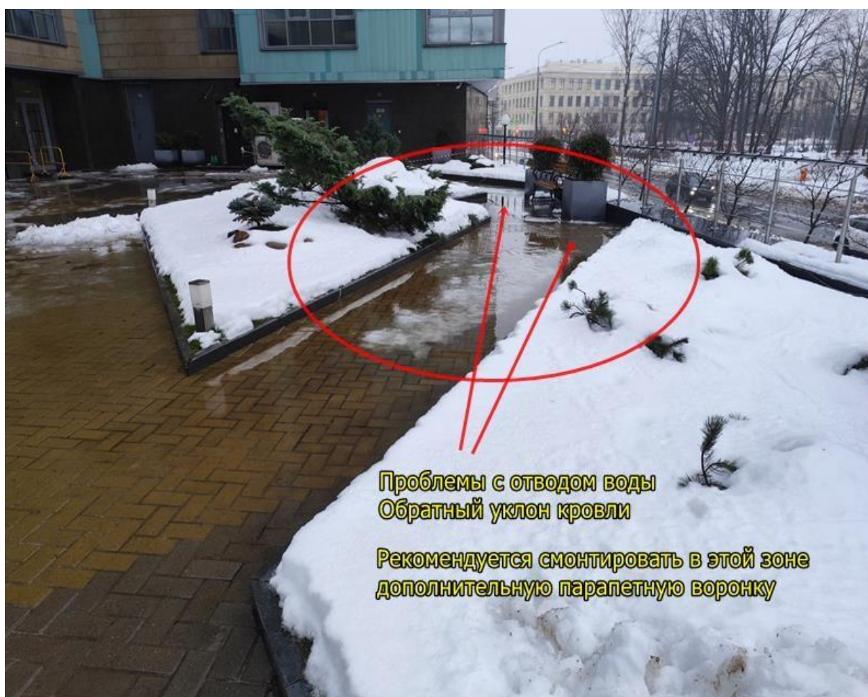
Фото 6 Застойные зоны в районе парапета вдоль фасада на ул. Гребная Рекомендуется устройство дополнительной парапетной воронки чтобы отводить воду из этой зоны прямо на газон
